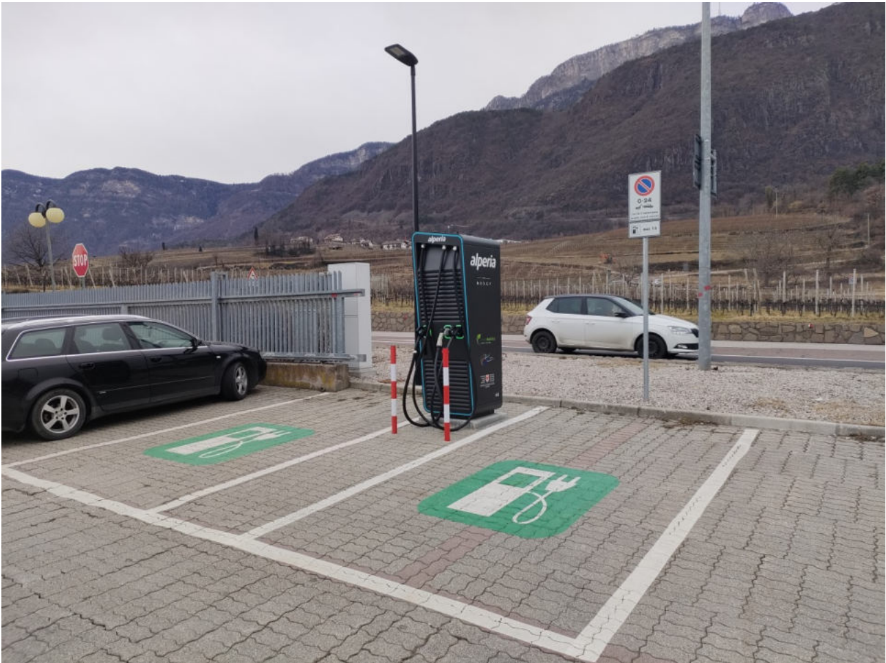
Figura 151 Stazioni di ricarica per auto elettriche a Bolzano (via Piave)
