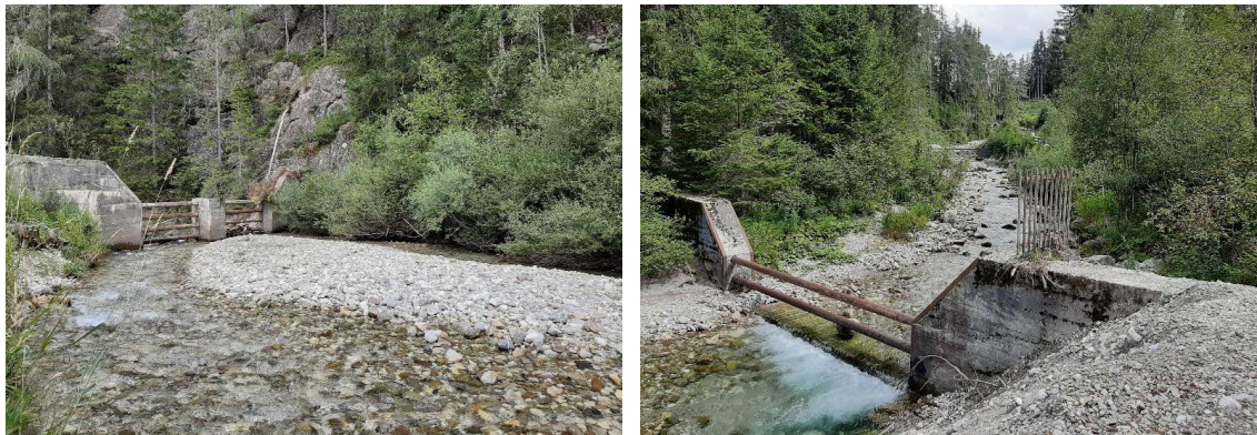
Figura 3. Alcune immagini delle briglie filtranti esistenti lungo il Rio di Sesto nei pressi del sito in cui è prevista la realizzazione dell'opera di diversione e del portale Sud del nuovo tunnel stradale.
