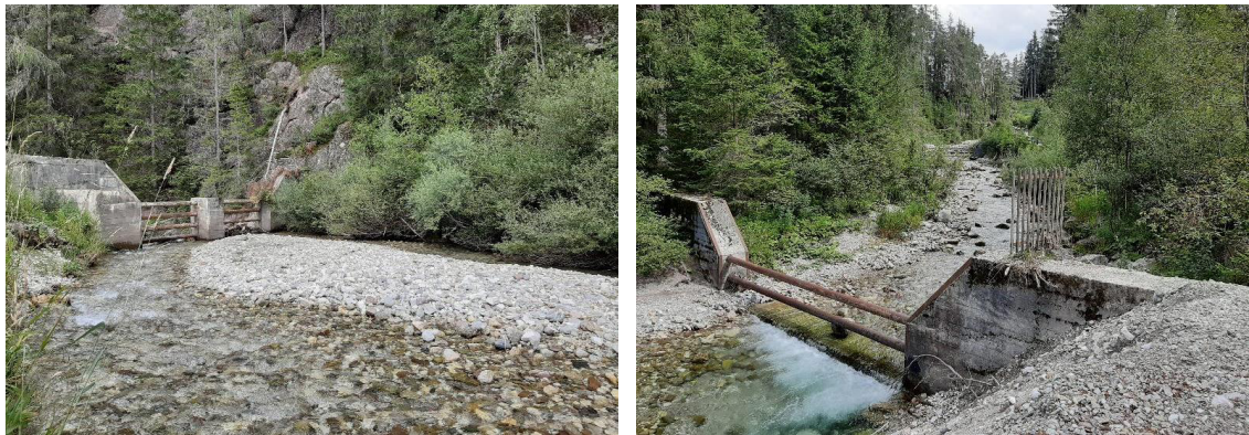
Abbildung 3. Einige Abbildungen der bestehenden Filtersperren entlang des Sextnerbaches im Bereich des geplanten Ableitungsbauwerks und des Südportals des neuen Straßentunnels.
