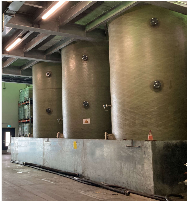
Abbildung 5: CP-Anlagen (CP 5+ 6+7) mit Auffangwanne
