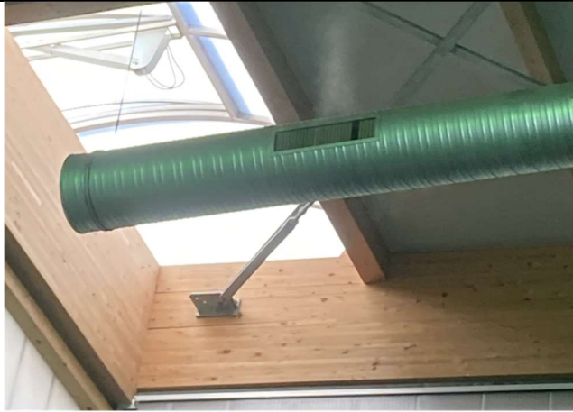
Abbildung 7: Abluftrohr mit Schiebevorrichtung
