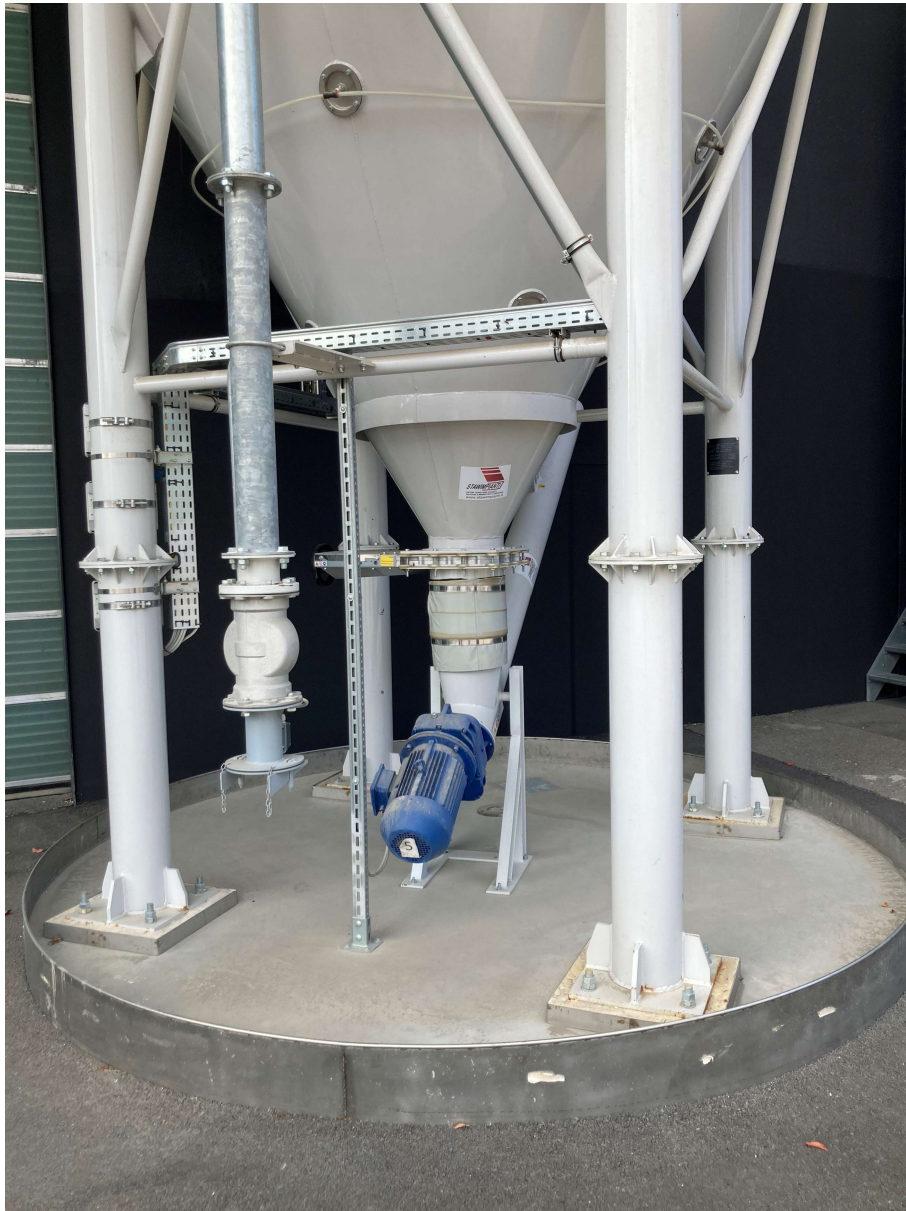
Abbildung 11: Motor des Kalksilos im Außenbereich
