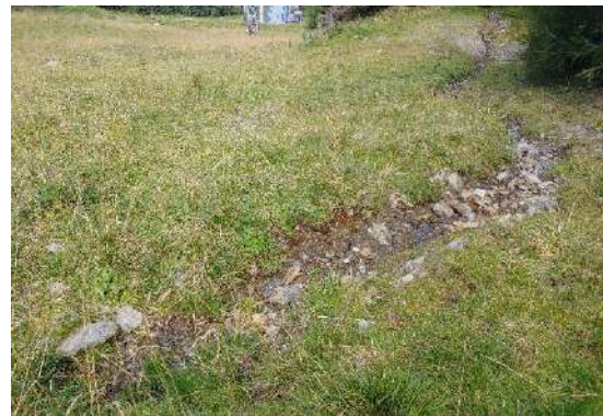
Wasseraustritt direkt talseitig der Baufläche von Stütze 6.
