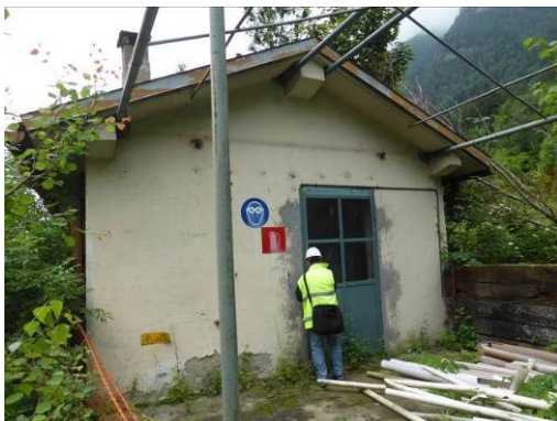
Edificio Gebäude „A6“ – Rifiuti esterni
