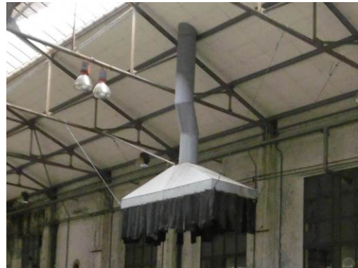
Cappe di aspirazione nella Rimessa
