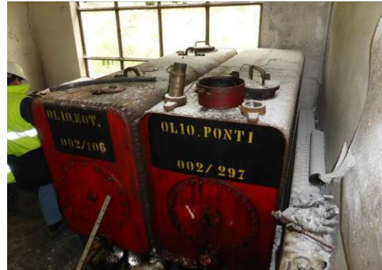
Rifiuti deposito olii
