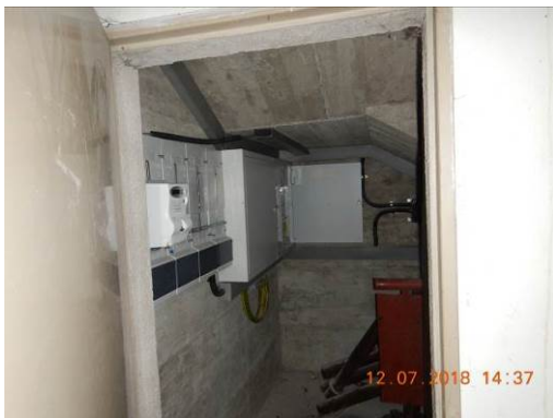
Locale contatori – Piano interrato
