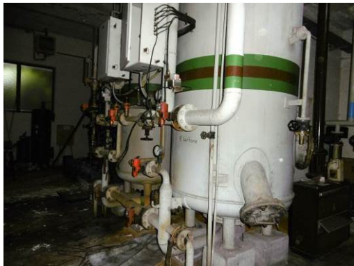
Silos carboni attivi
