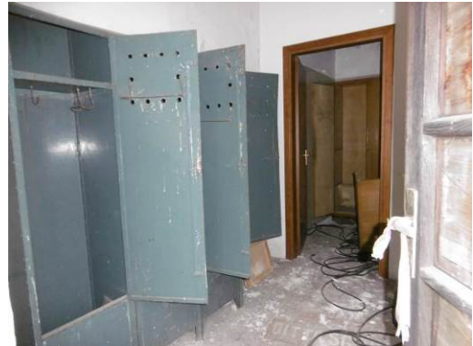
Edificio Gebäude „A6“ – Rifiuti interni
