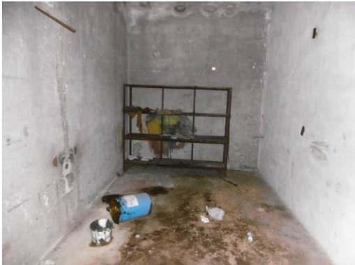
Edificio Gebäude „A6“ – Rifiuti interni
