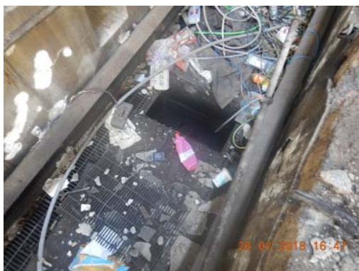
Canaletta di raccolta acque delle fosse
