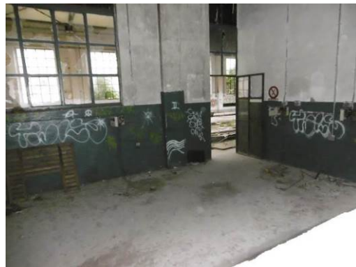
Rifiuti vano officina
