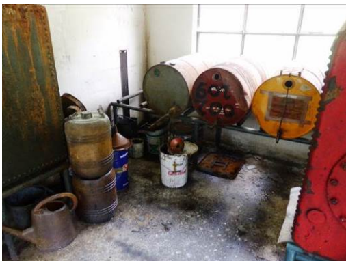
Rifiuti deposito olii
