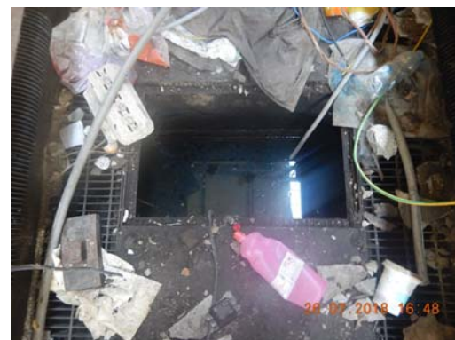
Canaletta di raccolta acque delle fosse
