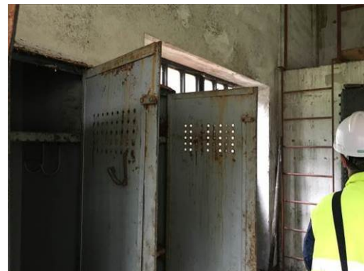
Rifiuti deposito olii
