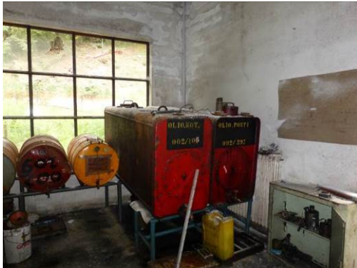
Rifiuti deposito olii
