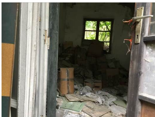
Edificio Gebäude „A6“ – Rifiuti interni
