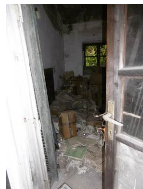
Edificio Gebäude „A6“ – Rifiuti interni
