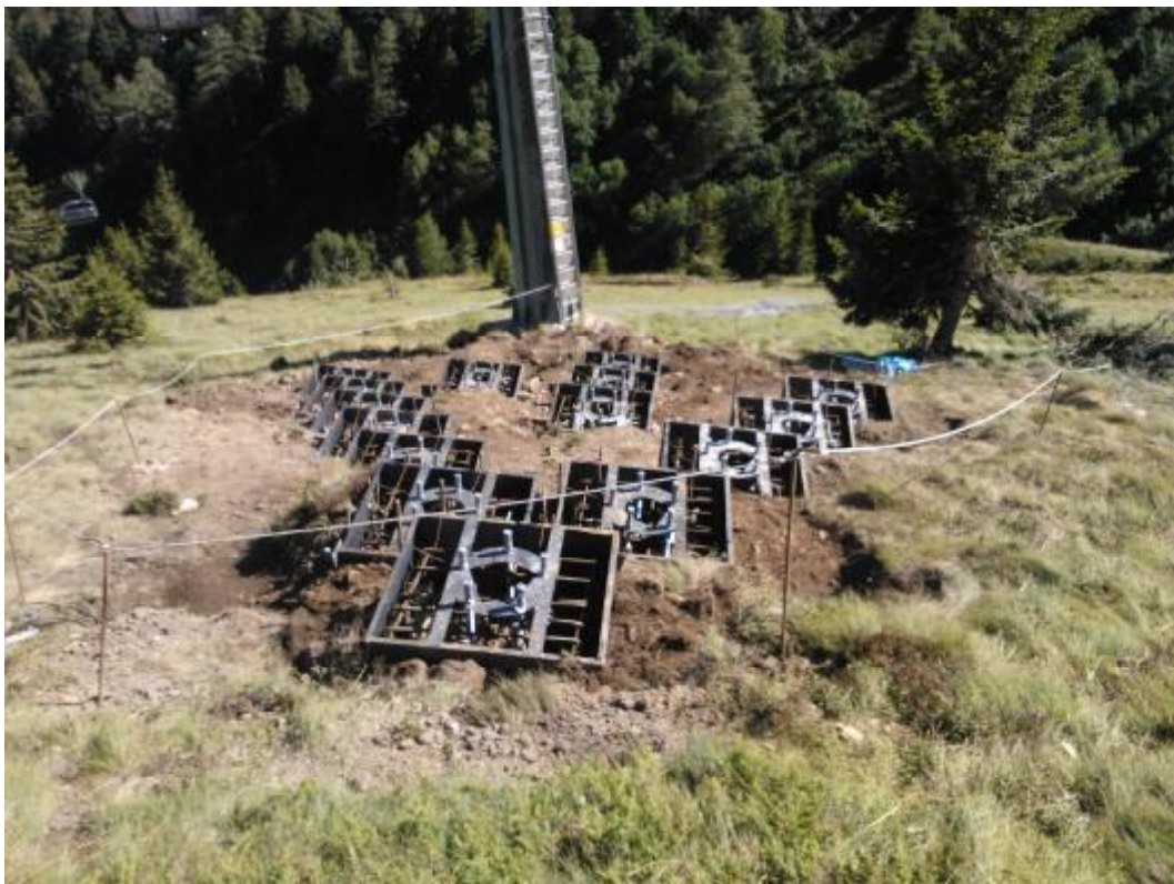
Foto A. Plinti di fondazione su micropali della struttura metallico del cuneo..
