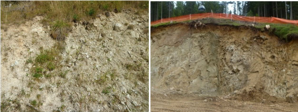
Abbildung 6.3: Links: Stark aufgelockerter und verwitterter Granit oberhalb der Almen „Gampen“; Rechts: Aushub an der Talstation Gaisjochbahn (Sommer 2011) in verwittertem bzw. stark zerlegtem Granit, im unteren Aushubabschnitt ist das ursprüngliche Felsgefüge größtenteils noch erhalten.
