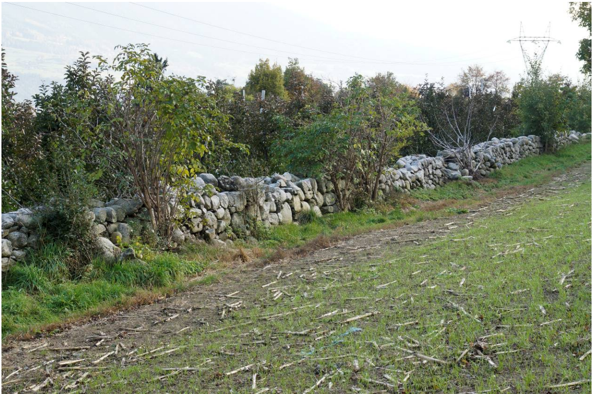
Abbildung 21: Zustand der bestehenden (zu sanierenden) Trockenmauer mit einigen Sträuchern
