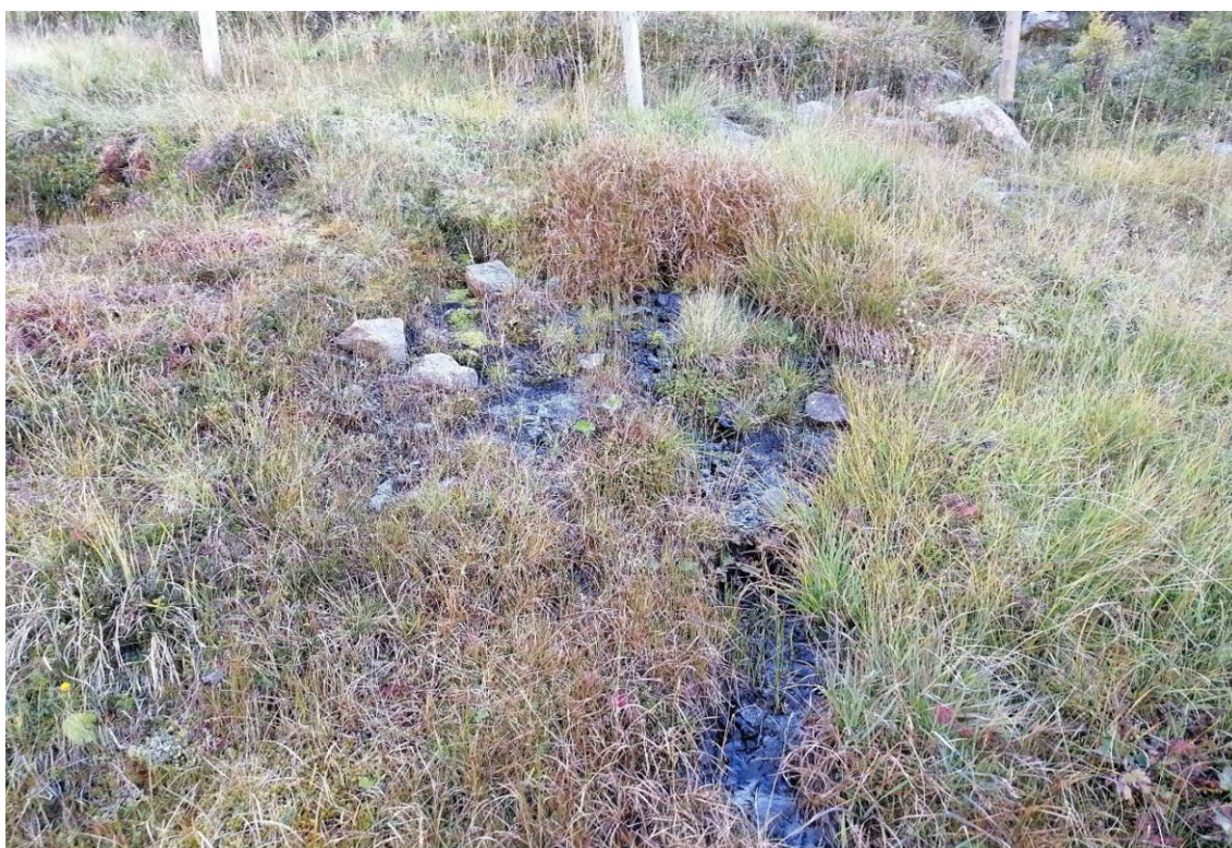
Abbildung 2.8: Erhebliche Hangwasseraustritte durch den Geländeanschnitt
