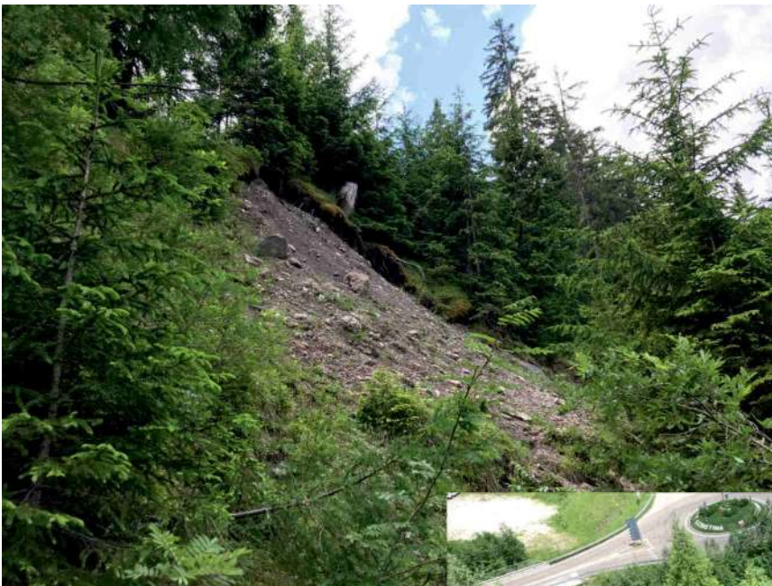
Vista del coronamento della vecchia frana, stabilizzata dall'Ufficio bacini montani, posta a ovest del sostegno "R2"; ad oggi si evidenziano blocchi rocciosi in stabilità precaria e fenomeni erosivi causati dall'azione dell'acqua piovana.
