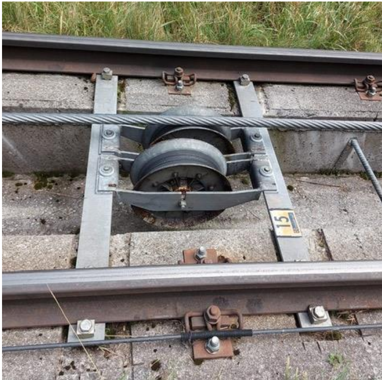
Bild 3: Streckenseilrollen mit getrennter Befestigung auf Stahlbetonuntergrund
