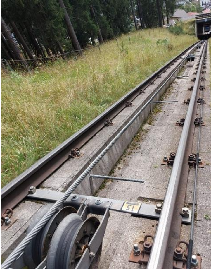
Bild 4: Gleisführung in der freien Strecke
