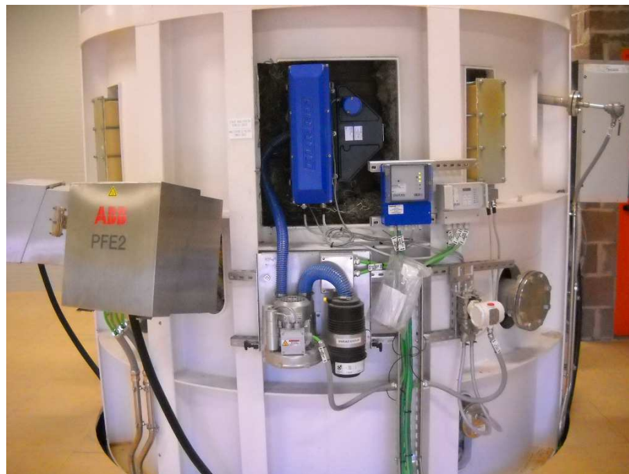
Dettaglio sonde prelievo misuratori in situ
