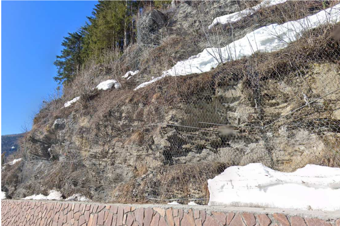
Abb.8: Anliegende Schutznetze auf Felsvorsprüngen südlich des untersuchten Abschnitts der SS12
