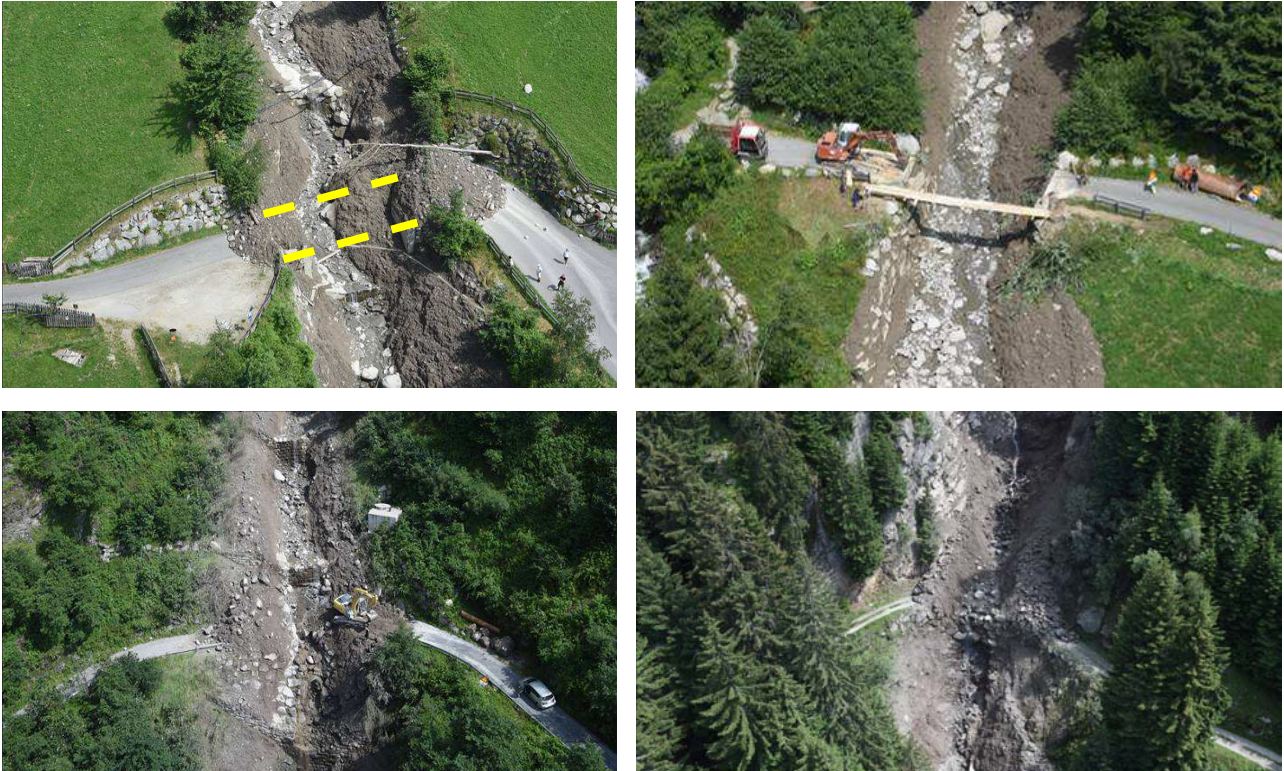
Abbildung 5: Der Höllentalbach hat ein sehr großes Geschiebepotential im oberen Einzugsgebiet. Das mobilisierte Geschiebe durchpflügt den Graben im steilen Hang und bewirkt schwere Schäden an den Bachquerungen
