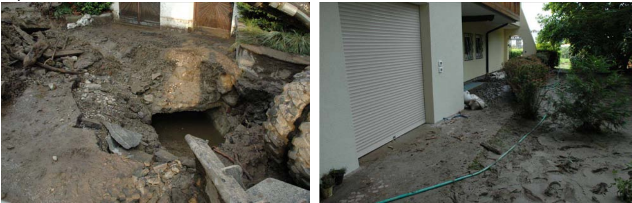
Abbildung 6: Bei Unwetterereignissen kann der Mühlbach die Wassermassen nicht bewältigen. Die Schäden sind nicht allzu schwer, aber häufig, und könnten durch einfache Bau- oder Organisationsmaßnahmen noch vermindert werden
