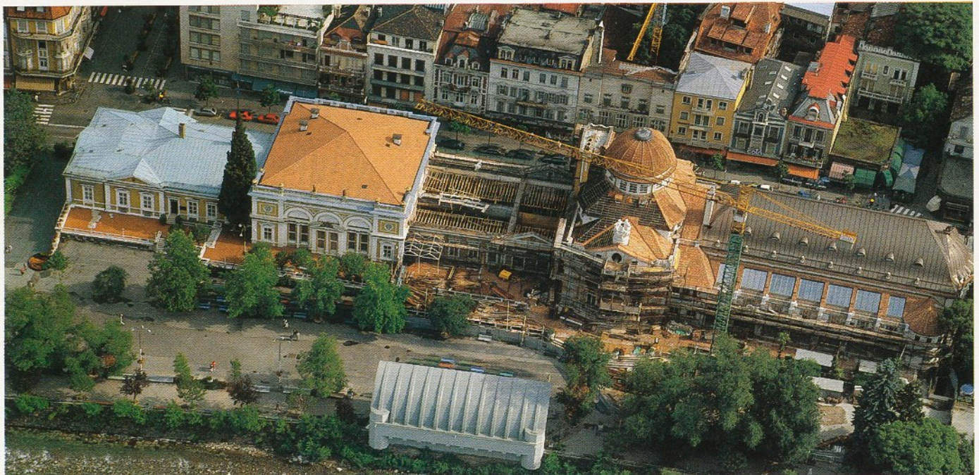
Der bestehende Kurhauskomplex während der Restaurierung: rechts der Neubau von 1914, links der erhalten gebliebene Altbau von 1874
